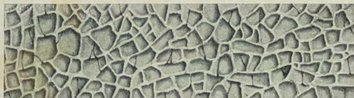
Impermeabilização asfáltica oxidada, pela ação das intempéries tendo perdido sua elasticidade
